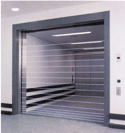
Bild 1.6 Sicherheitslichtgitter am Lastenaufzug [Q.1]
